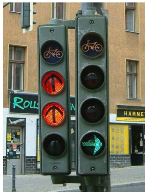
Sygnalizacja kierunkowa dla rowerów w Berlinie. (fot. M.Beim)
